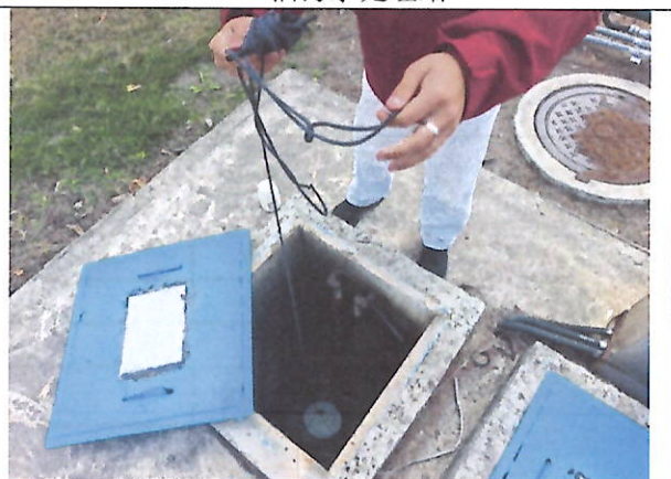
W4 1#生活污水处理站
